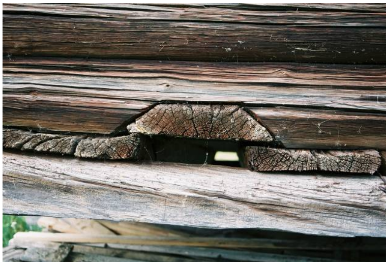
Bild 11. Detalj av urtaget i C1 för halvklovan som täcker springan i golvet. Jlm 06m54/15
