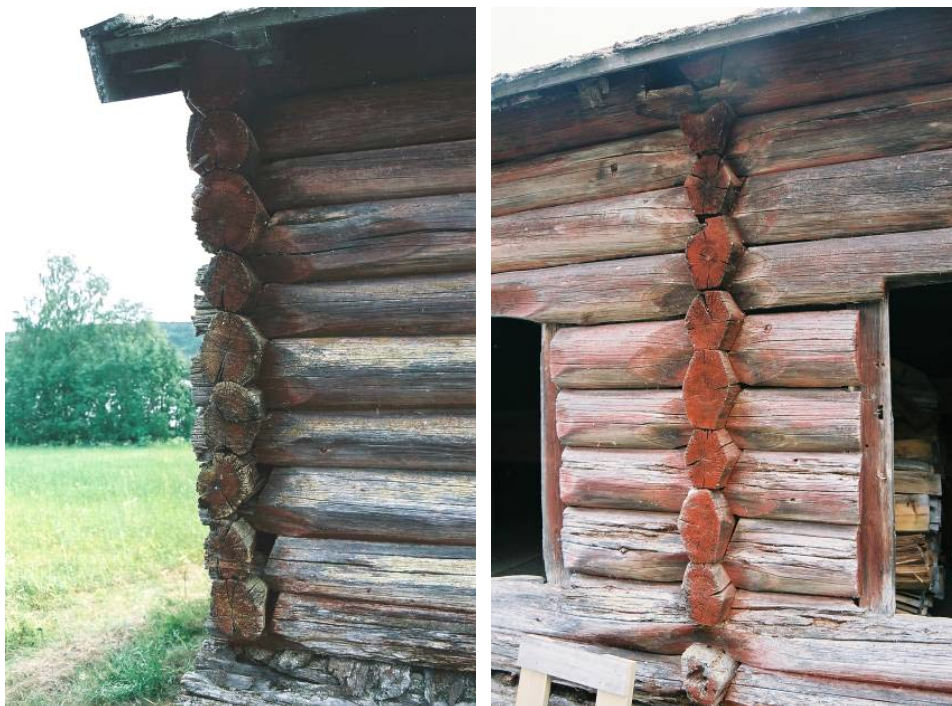
Bild 12 & 13. B- respektive E-väggens knutkedjor i A-vägg. Notera skillnaden på skallarnas form och kondition. Jlm 06m54/12 & 11.
