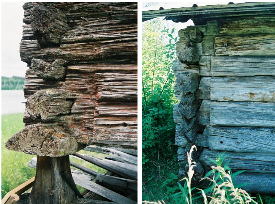
Bild 34 & 35. Urtagen utmed BC-knut vid B-väggen på dubbelboden (vänster) och ladan (höger), tyder på att byggnaderna varit sammanbyggda samt att det stått en timring mot väggen. Jlm 06m54/35 & 06m56/24
